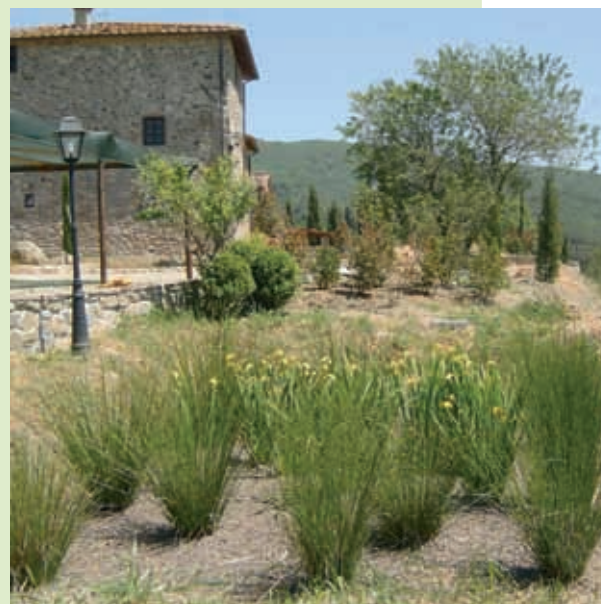
Impianto di fitodepurazione a flusso sommerso orizzontale da 20 mq, piantumato con scirpus.
